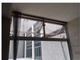
廊下の排煙窓を常時開放
